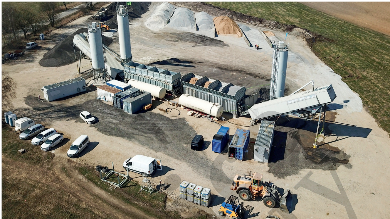
Obrázek 1: Mobilní betonárna (zdroj archiv Skanska a.s.)
